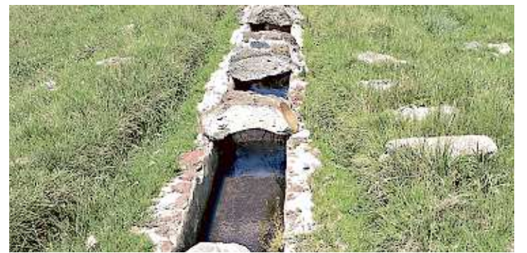
■ Los canales o apantles son perforados por pobladores para obtener agua, con lo que dañan el monumento y contaminan el líquido.
