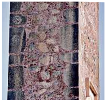
■ Manchas provocadas por el material usado en el reunte.
